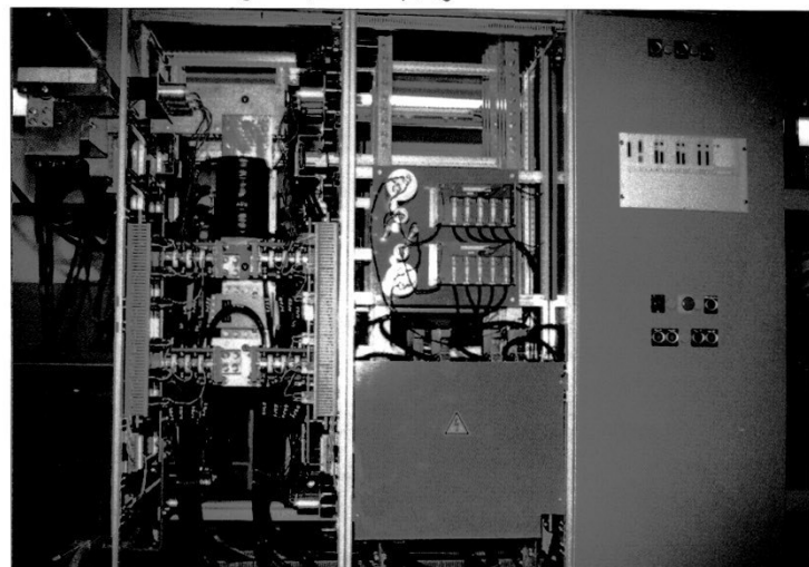
Bild 7: TWIN POWER-Anlage mit 4,8 MW/24-pulsig
